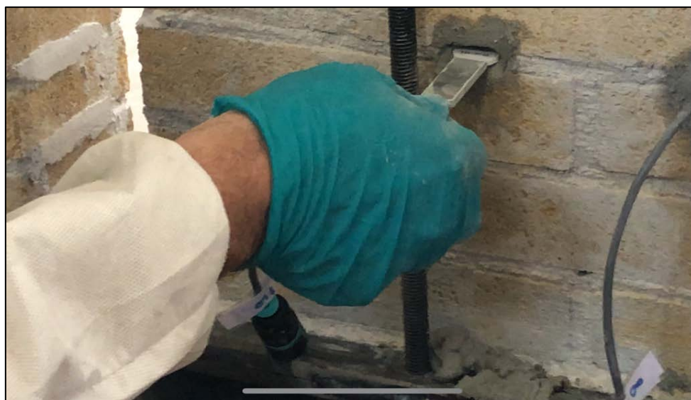
Figura 7.2.2 Primo sistema di post-installazione sensoristica STMicroelectronics: posizionamento della sensoristica.
