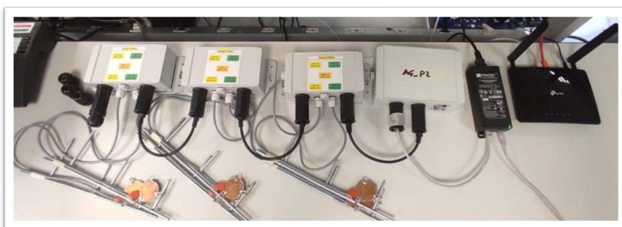
Figura 5.2.17 Foto di un sistema tipo utilizzato per le installazioni dei dimostratori del progetto in fase di test presso i laboratori STMicroelectronics.
