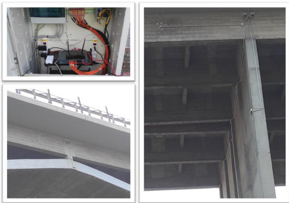
Foto dei sistemi installati e del sistema in fase di collaudo.
